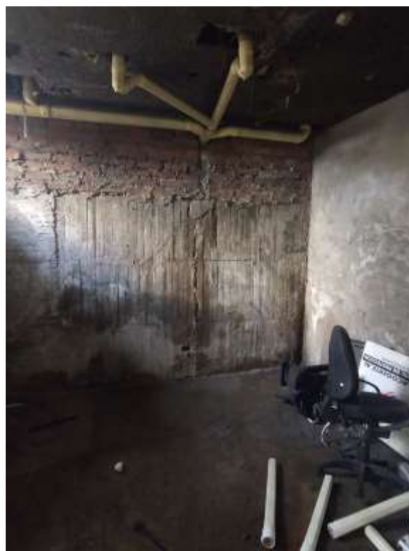
Imagen 2. Afectación en sótano en edificio migración
