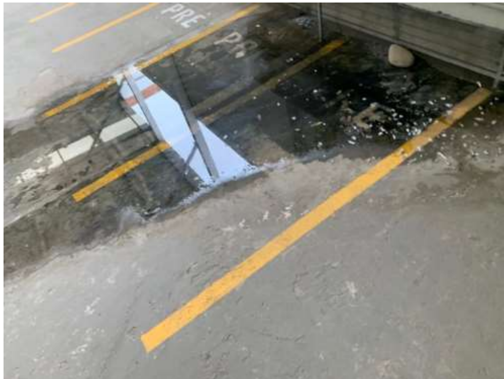
Imagen 1. Afectación en pista de motos
