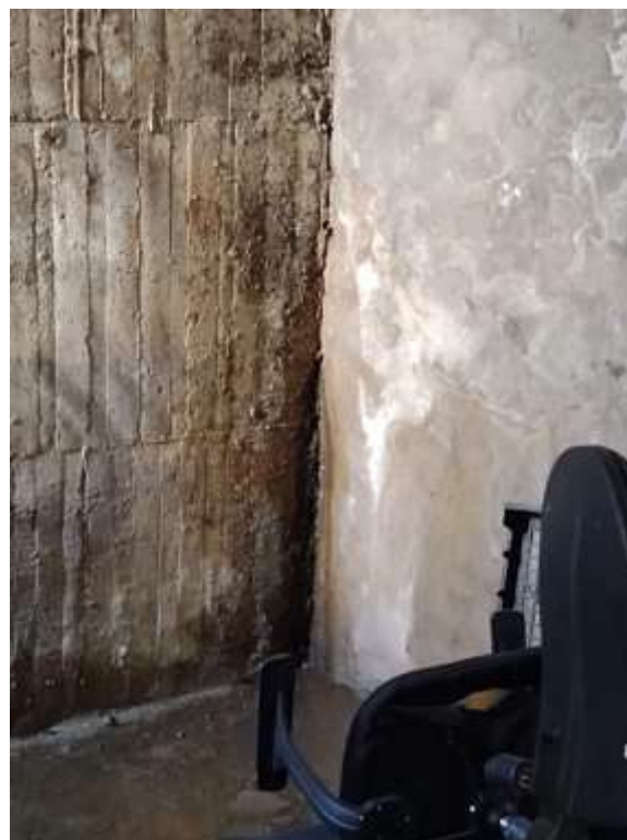
Imagen 3. Brote de agua en muro de contención de sótano
