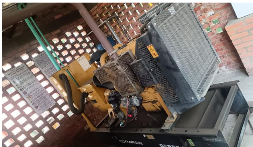
Imagen 1. Planta eléctrica OLYMPIAN.
